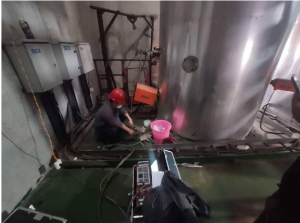
1#排气筒 DA001 (◎1) 有组织排放废气
